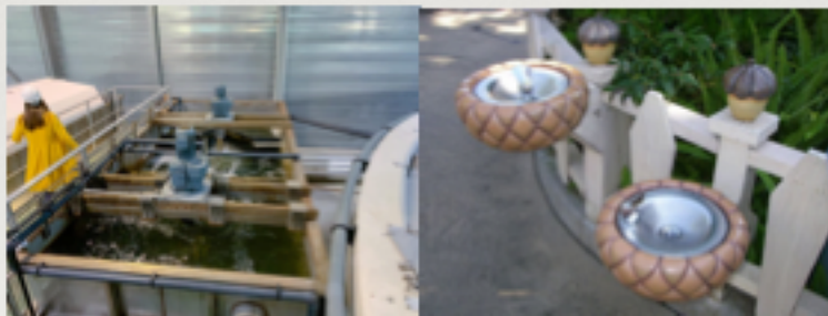
Une installation épure À Disneyland
